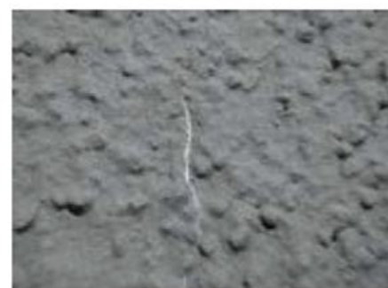
В местах появления термических трещин могут появляться известковые высолы.
