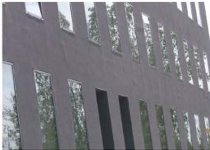
Примеры повреждения фасада, вызванного чрезмерным давлением пара
