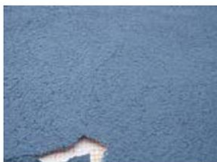
Трещины, возникающие от теплового напряжения, приводят к отслоению штукатурного слоя.
