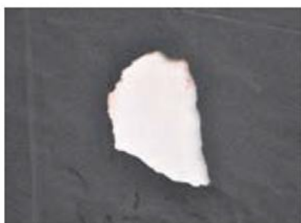
Со временем, обычно после зимнего сезона, в местах появления вздутий штукатурный/окрасочный слой отслаивается.
