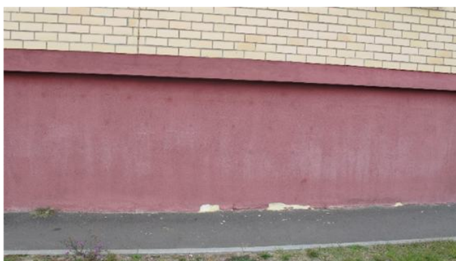
* Фото – повреждение цоколя из-за систематического переувлажнения (отслоение штукатурки с краской и высолы)
