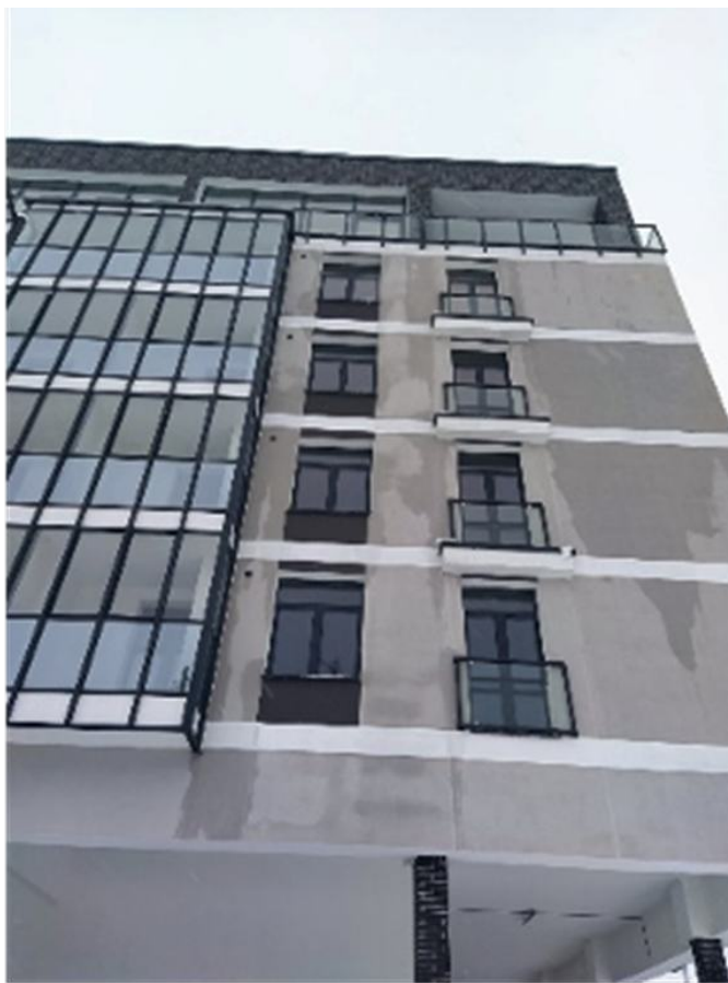
* Фото – намокание стен из-за высокой водопроницаемости окрасочного покрытия
